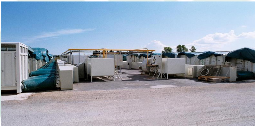
Trocknungsabschnitte mit Gebläse, Luftverteilkanaal und Anschlüssen an die Container
