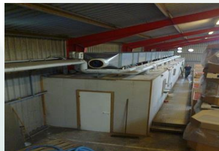
Neue Luftleitung am Trockner zu verteilen getrocknete Luft pro Abschnitt.
