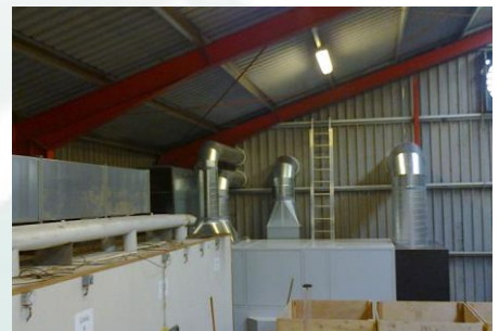
Die Luftleitung an neue Adsorption Luft Trockner zum Trocknen auf weniger feucht Inhalte des Saatgut.
